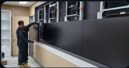
경기도청 상황실 멀티비전 설치
